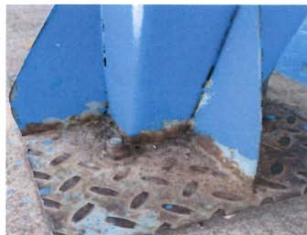
Foto 4: Estructura en mal estado
