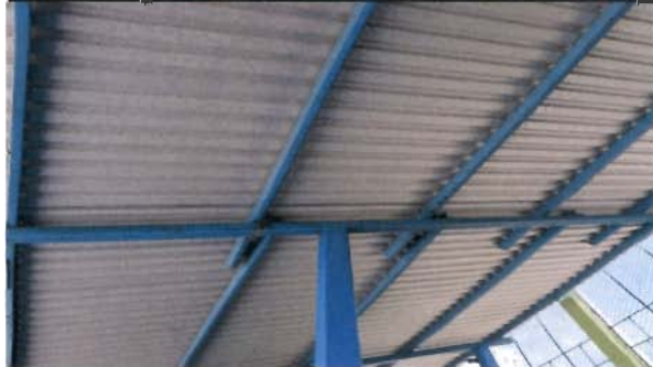
Foto 2: Sustrucción de lámina lado derecho.
