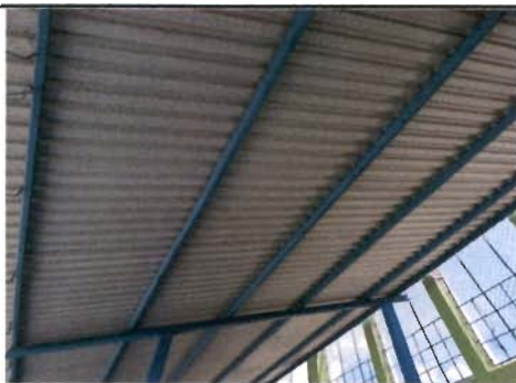
Foto 3: Sustrucción de lámina.
